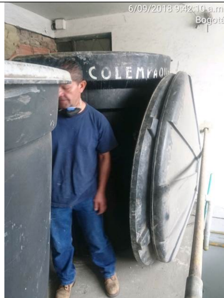
Foto No. 4. Sistema de tratamiento de ARnD.
